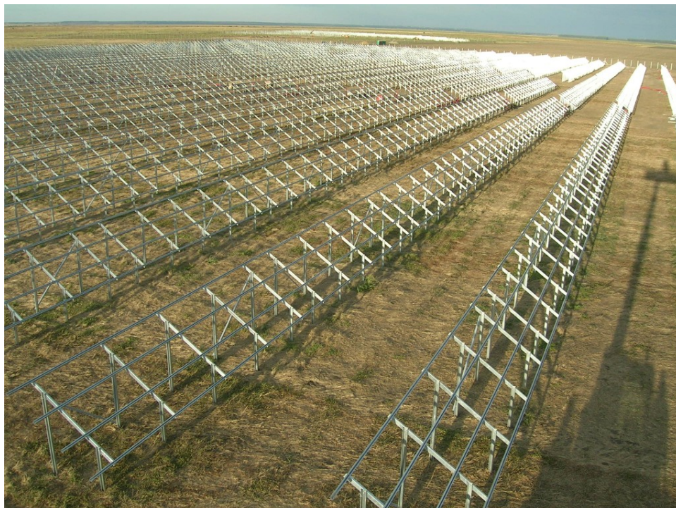
SOLARIA GREEN ENERGY – URZICUTA 7,7 (Centrală Fotovoltaică), com. Urzicuta, localitatea Craiova, jud. Dolj.
