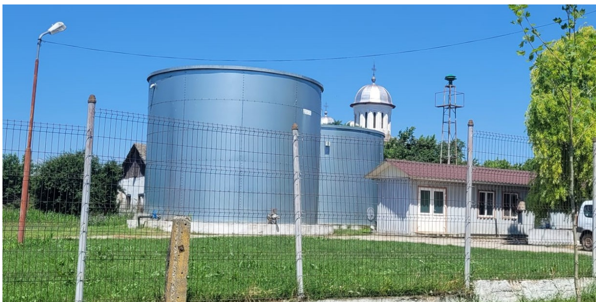
Sistem de canalizare menajeră în comuna Urzicuța, județul Dolj – Stație vacuum comuna Urzicuța
