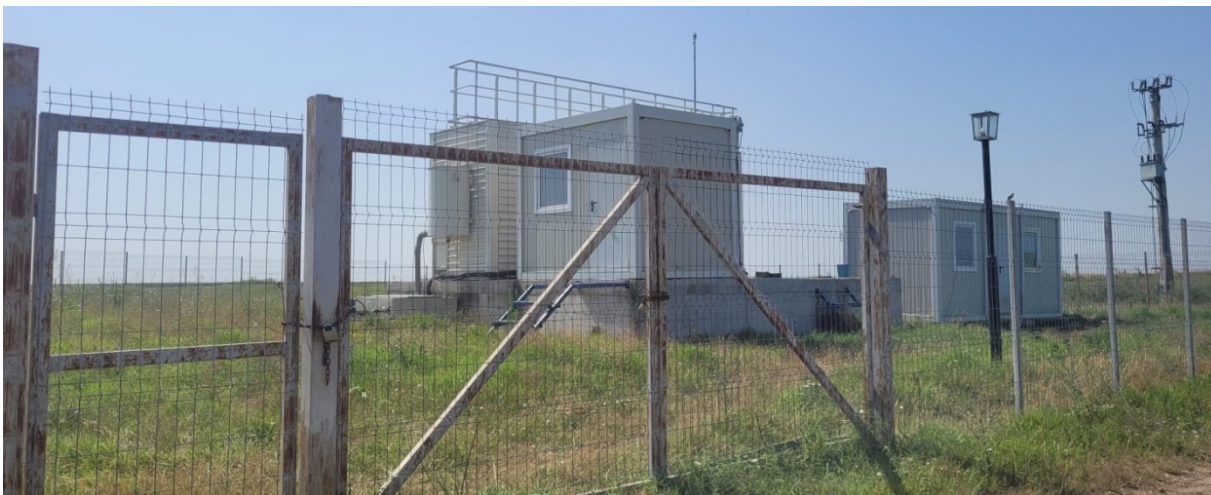
Sistem de canalizare menajeră în comuna Urzicuța, județul Dolj – Stație epurare comuna Urzicuța
